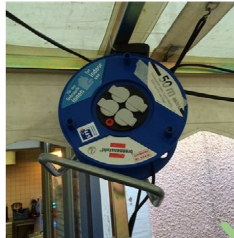
Kabelen op der richteger Längt erauszéien. Vermeiden dass Kabelen sou um Buedem leien. (Stolperfalen a Gefor vu Beschiedegunge vun de Kabelen)
