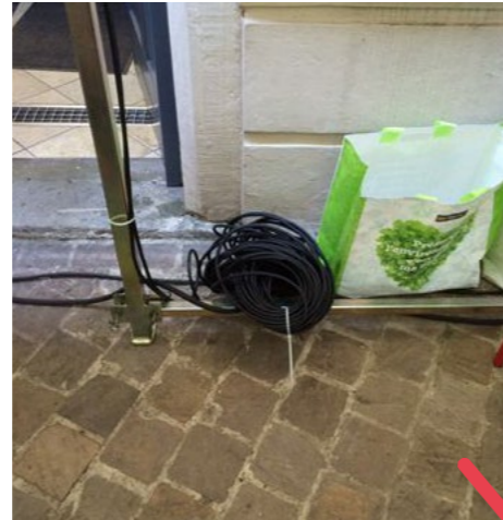
Enner Belaaschtung Kabeltrommel net opgewéckelt loossen = Iwwerhëtzunggefor
